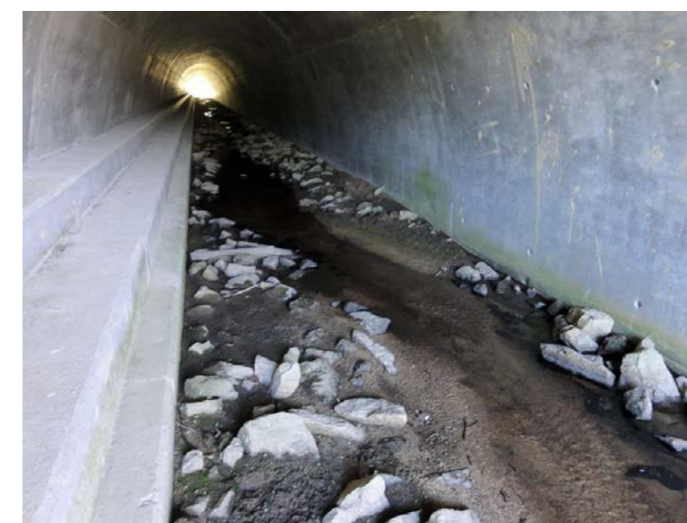
Exemple de fond reconstitué dans un ouvrage à radier artificiel [Source : Egis]
