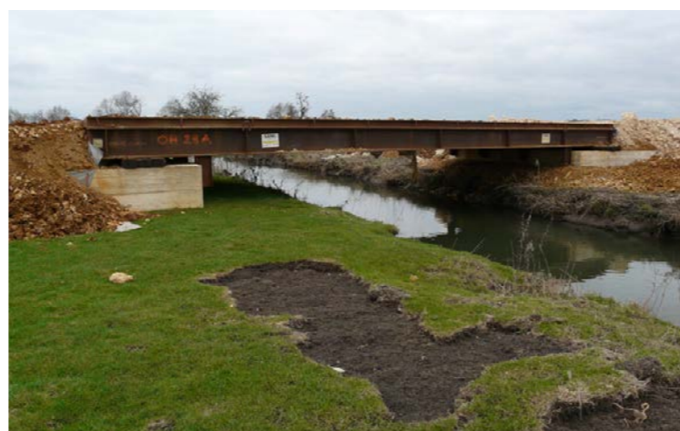
Exemple de pont provisoire (Source : Egis)
