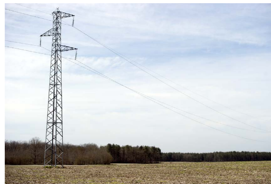
Ligne électrique sur la commune de la Ville-Dieu-du-Temple [Source : RFF - Paul Robin]
