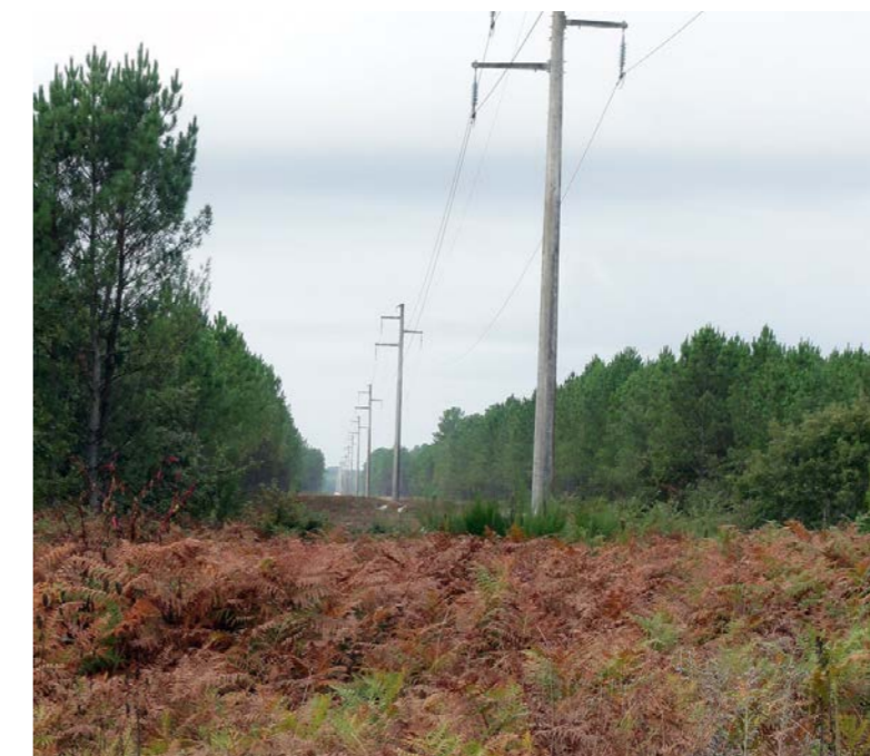
Ligne électrique haute tension sur la commune de Préchac (Source : Egis)
