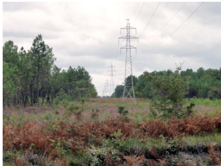
Ligne électrique sur la commune de Saint-Michel-de-Rieufret [Source : Egis]
