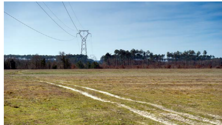
Ligne électrique Haute Tension à Saint-Yaguen [Source : RFF - Paul Robin]
