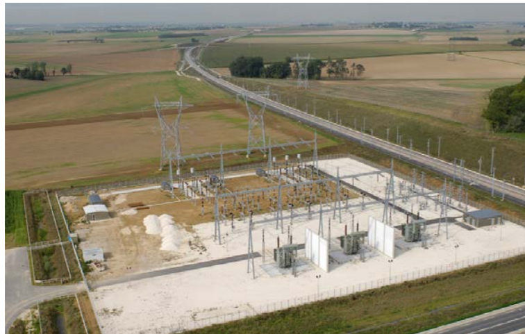
Sous-station de LGV [source : RFF]
