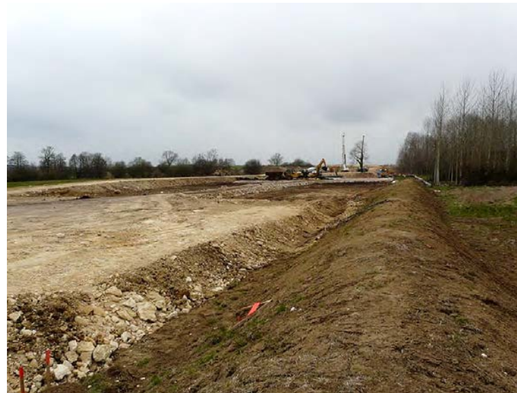
Dépôt provisoire de terre végétale, mis en œuvre en merlon masquant en partie le chantier (Source : Egis 2009)
