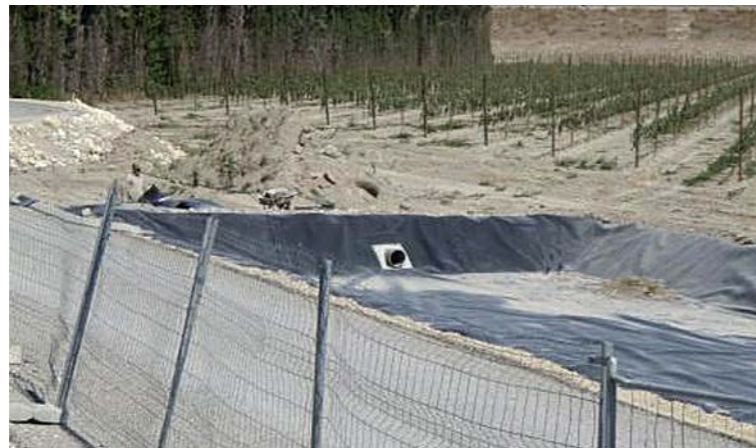
Bassin provisoire d'assainissement (source : Inexia, Chantier du viaduc d'Orgon)
