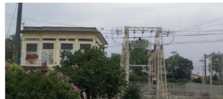
Sous-station de Saint-Jory depuis la RD820 (Source : Google Maps)
