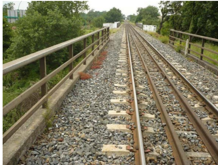
Exemple de système anti-déraillement (Quart Nord Est Midi-Pyrénées, Source : INEXIA, 2010)
