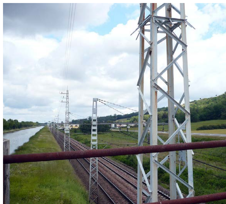
Voie ferrée le long du canal latéral à la Garonne [Source : Egis]
