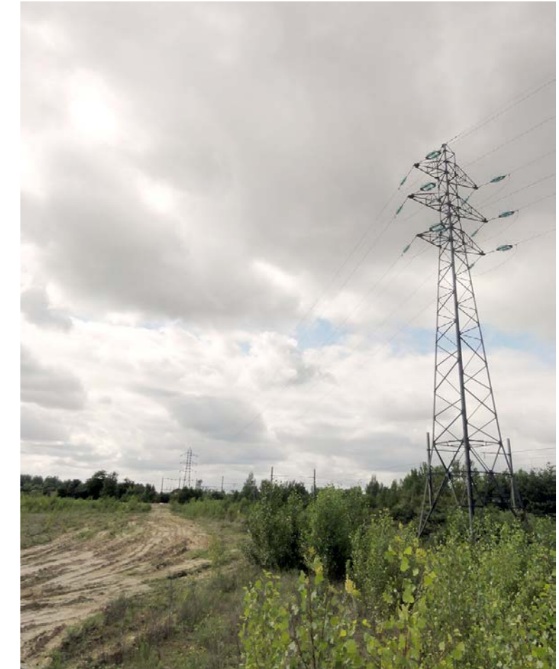
Ligne électrique le long de la ligne ferroviaire Bordeaux-Sète sur la commune de Saint-Médard-d'Eyrans (Source : Egis, 2012)
