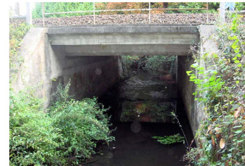
Ouvrage existant de franchissement de l'Eau Blanche par la ligne ferroviaire Bordeaux-Sète (Source : Egis, 2012)
