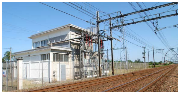
Exemple de sous-station d'alimentation électrique, sur la ligne Bordeaux-Hendaye [source : RFF]
