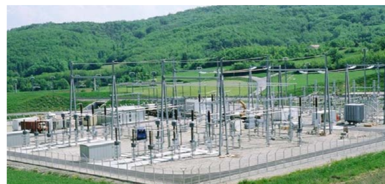
Exemple de sous-station [Source : RFF]
