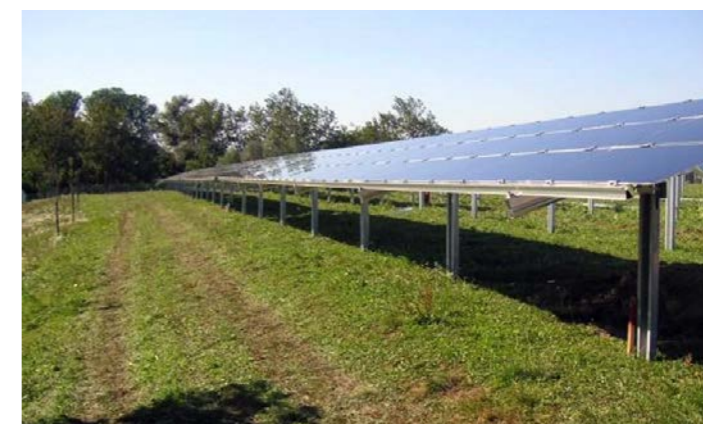
Panneaux photovoltaïques [Source : BPU]
