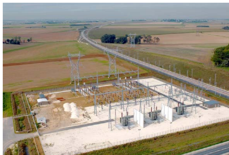
Sous-station électrique [Source RFF]
