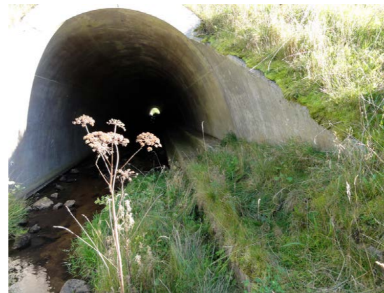
Ouvrage aménagé pour la faune semi-aquatique (Source : Egis)
