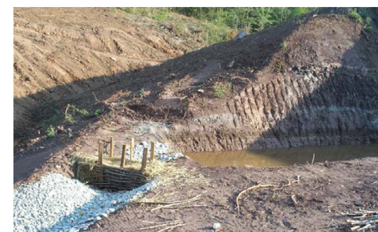
Exemple de filtre à paille mis en place à l'aval des bassins de décantation, avant rejet vers le milieu naturel (Source Egis)
