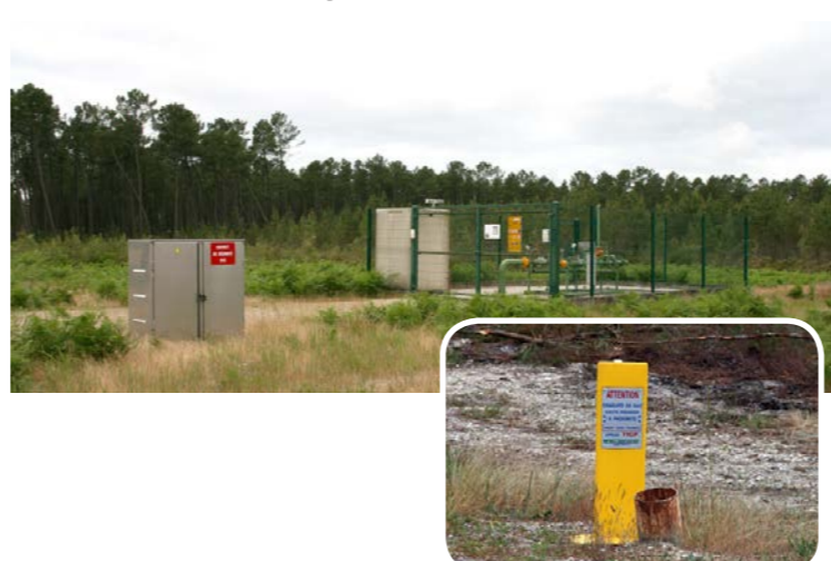
Installation liée au réseau de gaz [Source : Egis, 2012]
