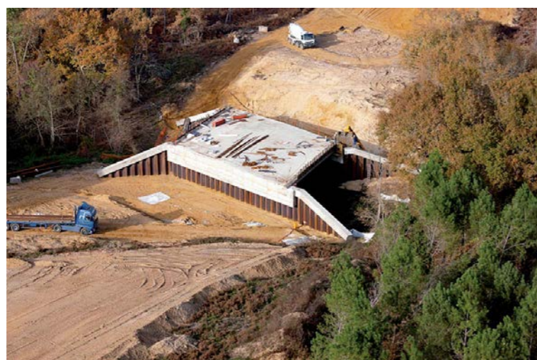
Mise en place d'un ouvrage de type portique avec préservation des berges (Source : Egis)
