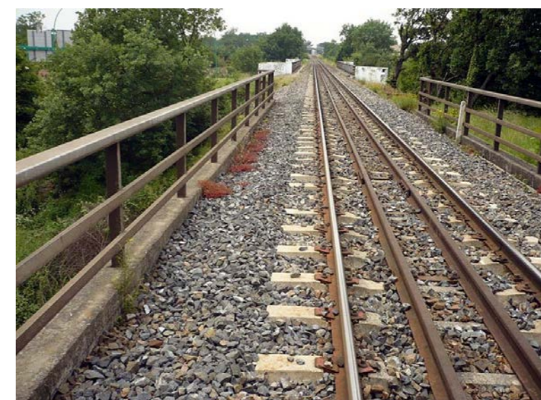
Exemple de système anti-déraillement à la traversée de l'Hers mort (Source : Systra)
