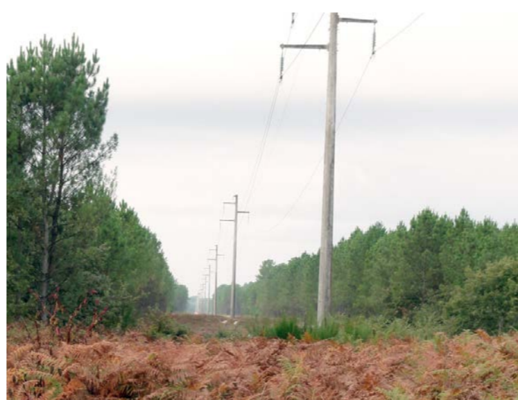
Ligne électrique [Source : Egis, 2012]
