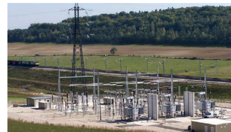
Sous-station de LGV [source : RFF]
