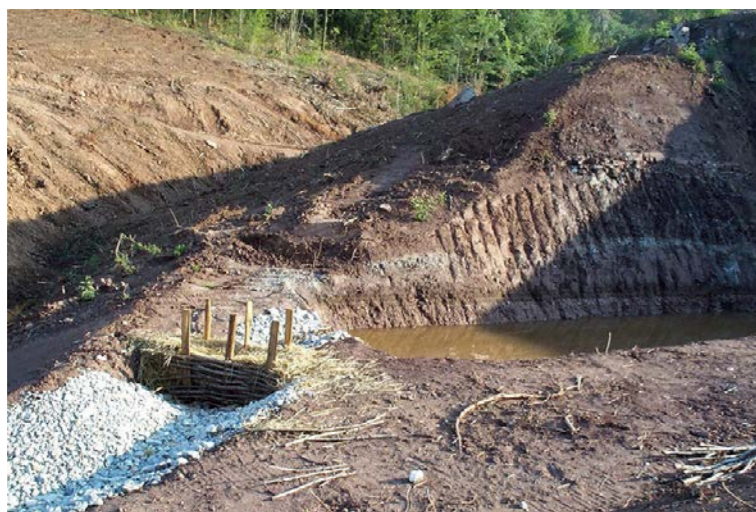
Exemple de filtre à paille en aval d'un bassin d'assainissement [Source Egis]
