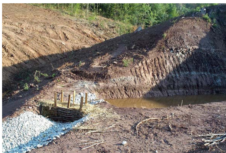
Exemple de filtre à paille en aval d'un bassin d'assainissement [Source Egis]
