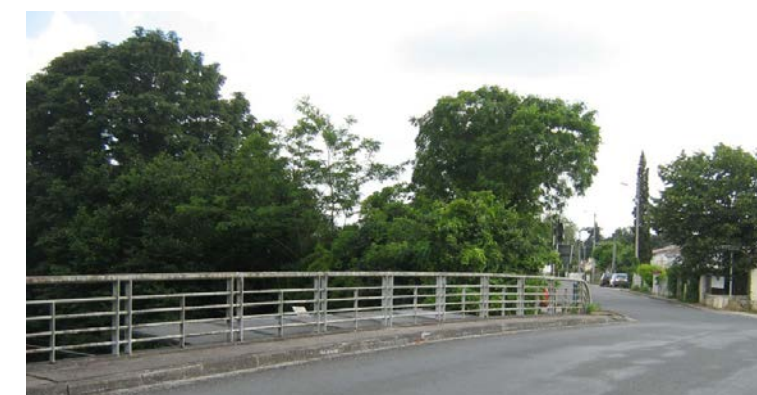
L'avenue du Sable d'Expert au niveau du franchissement de la ligne existante à Saint-Médard-d'Eyrans (Source : Egis, 2012)
