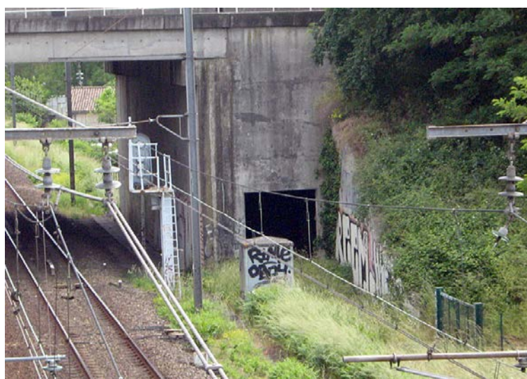
Ouvrage de franchissement de la ligne existante par la rocade (Source : Egis, 2012)
